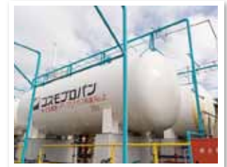
15tタンク4基
